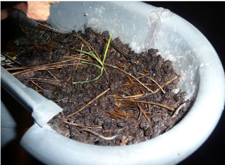
Abbildung 2. Nest der Türkentaube in der Dachrinne eines Wohnhauses in Neckargröningen LB in 7,5 m Höhe über dem Grund. Die Dachrinne ist zwischen Fallrohr und Dachrinnenende vollständig ausgefüllt. Das Nest ist mit einer Kotschicht von den Jungvögeln abgedeckt (vgl. Abb. 3). Es wurde nach der Brutzeit geborgen. (Foto: Michael Nisi, Freiwillige Feuerwehr Remseck). - Collared Dove nest in the rain gutter of a house in Neckargröningen 7.5 m above the ground. The nest completely fills the gap between the end of the gutter and the drainpipe, and is covered with a layer of droppings from the young (c.f. Fig 3). It was recovered after the end of the breeding season.
